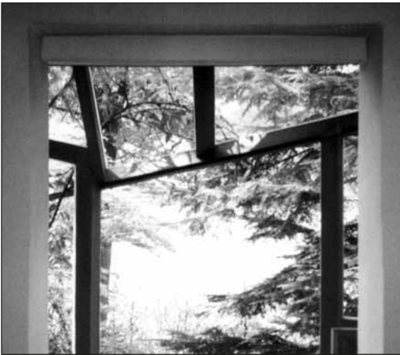
Abbildung 8: Alison und Peter Smithson, Hexenhaus, Riverbank Window , Blick auf die Weser, Bad Karlshafen, 1990
